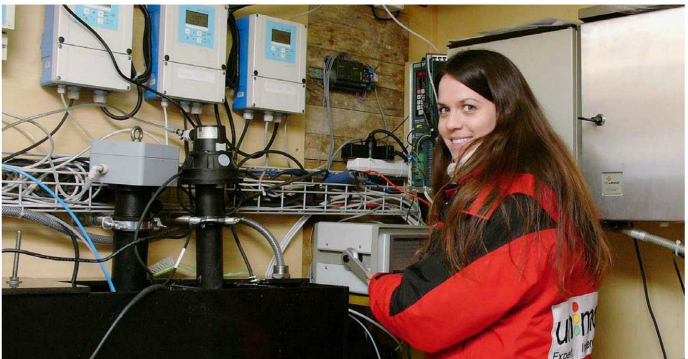
Martina Hofer wartet die Onlinemesssysteme in einer mobilen Messstation.
